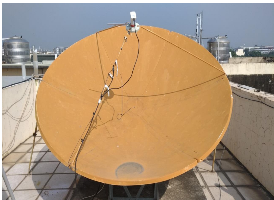
照片 2：臺南機房頂樓衛星天線
