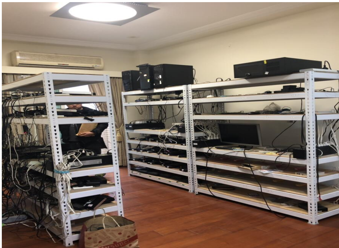
照片 4：南部轉換視訊訊號到網路之傳輸機房
