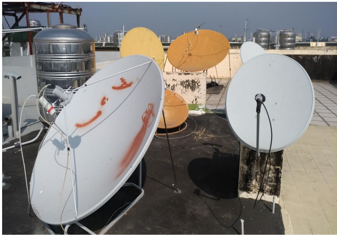
照片 1：臺南機房頂樓衛星天線
