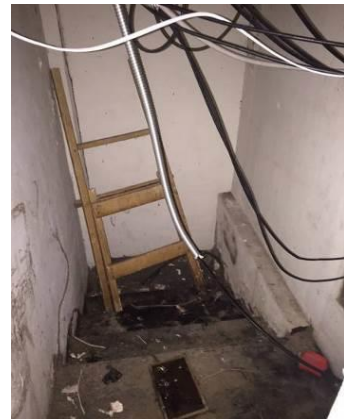
104.11.20 B1F B 棟管道間
