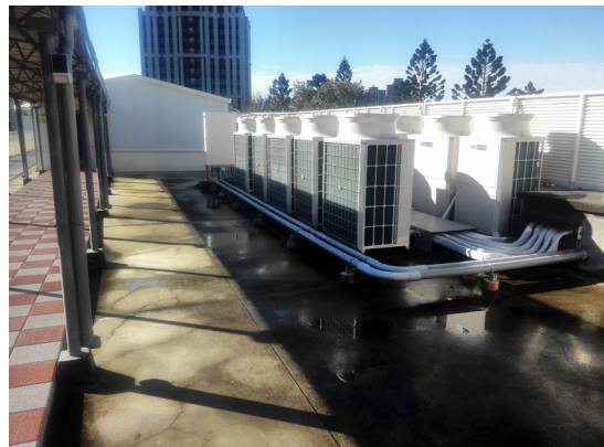
107.01.29 4F VRV 空調室外機
