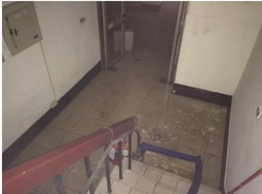
104.11.20 B1F A 棟樓梯淹水
