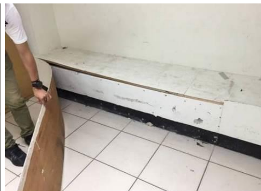
104.11.20 B1F B 棟反樑現況照片
