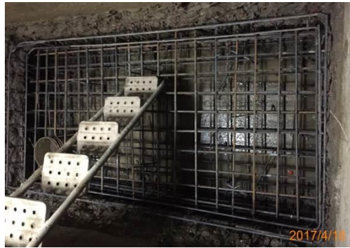
106.04.18 貨梯機坑深度調整
