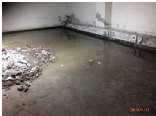
106.06.12 地下室漏水嚴重
