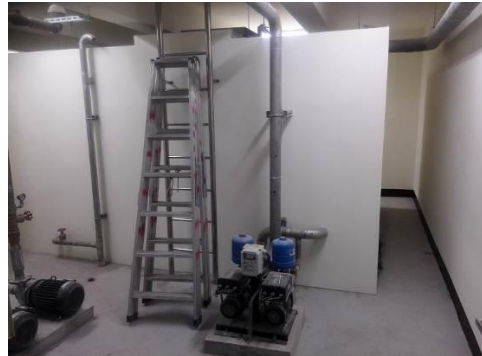
107.08.28 B1F 雨水回收室
