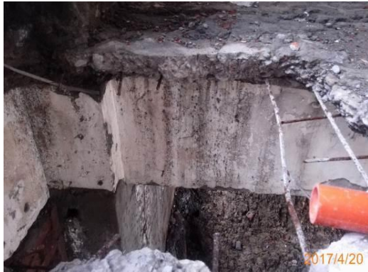
106.04.20 樓板僅單層 2 號鋼筋
