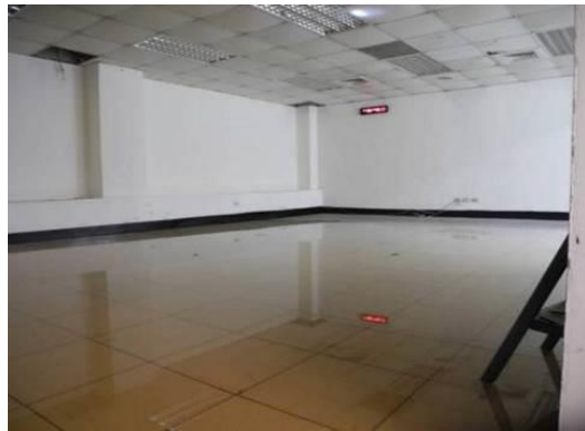
104.11.20 B1F B 棟辦公室淹水現況照片
