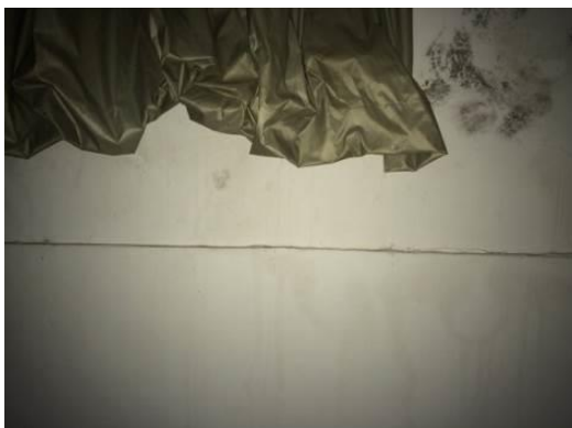
104.11.20 B1F A 棟窗戶漏水狀況
